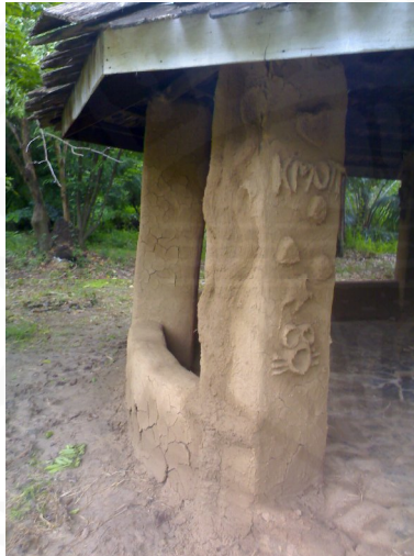
(ก) ความชื้นบริเวณกำแพงที่สร้างติดพื้นดิน
